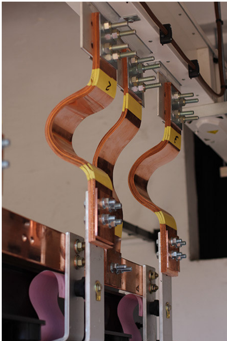
Conexões de transformadores de baixa tensão com barramento flexível. (fonte: eep.com)
