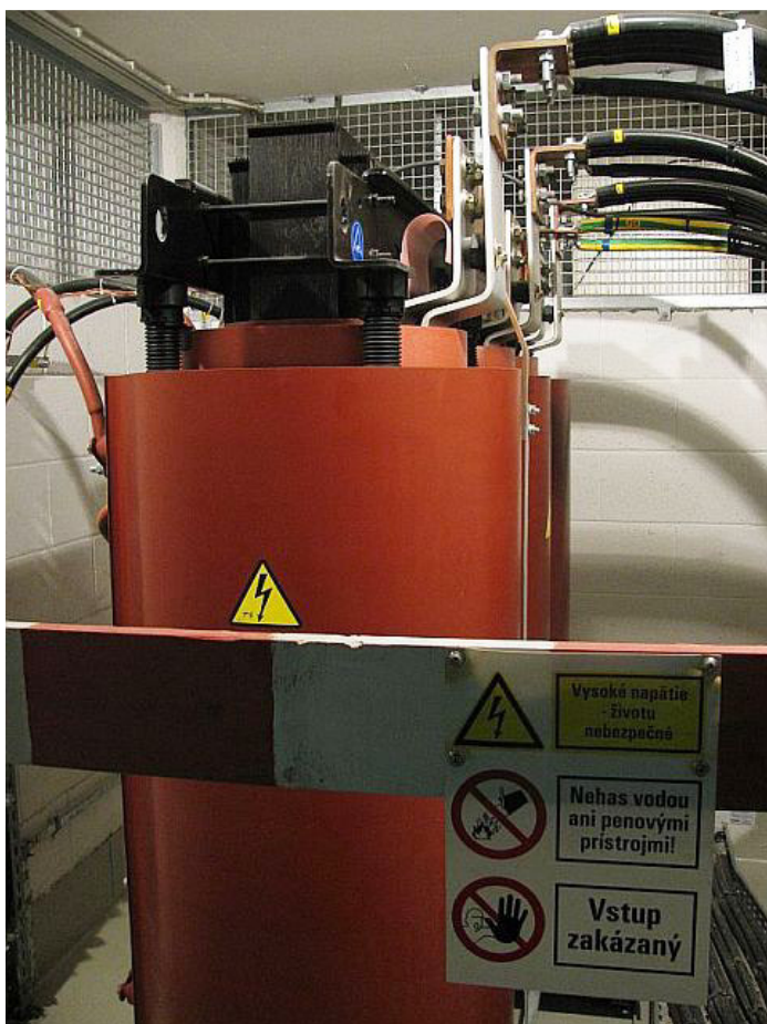
Transformador instalado e conectado (fonte: mrazik.info)
